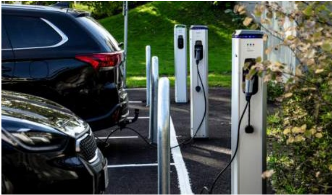
Reference: Ladestationer til elbiler foto: Eon.dk
